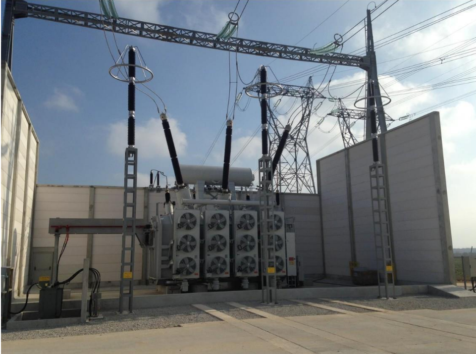
Figure 7 : Exemple de transformateur 400/90 kV entouré de 3 murs acoustiques et pare-feu (TR 742 existant sur le site)
