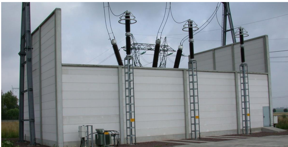
Figure 6 : Exemple d'Autotransformateur 400/225 kV entouré de 4 murs acoustiques et pare-feu
