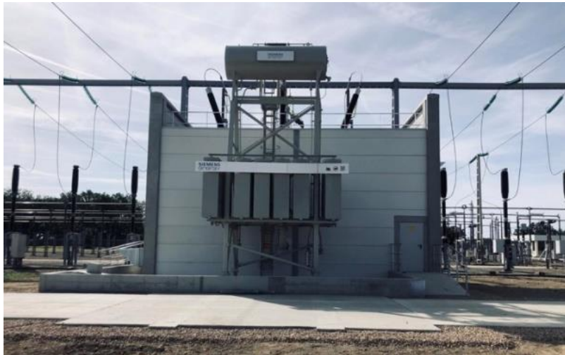
Figure 8 : Exemple d'une self à huile 225 kV dans une enceinte acoustique fermée
